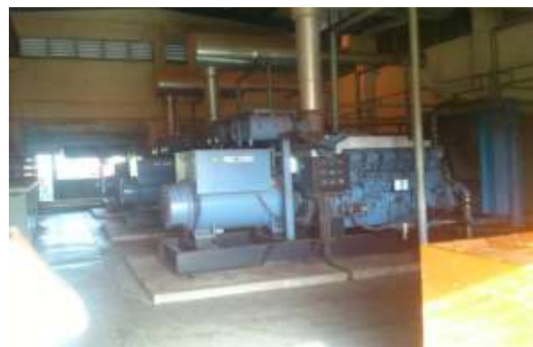
写真 11 既設発電機室(1,000kw×3 ジーゼル発電機)
