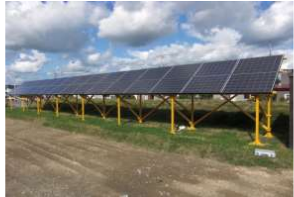
写真7 ペリズ国のソーラーバッテリーの設置状況
